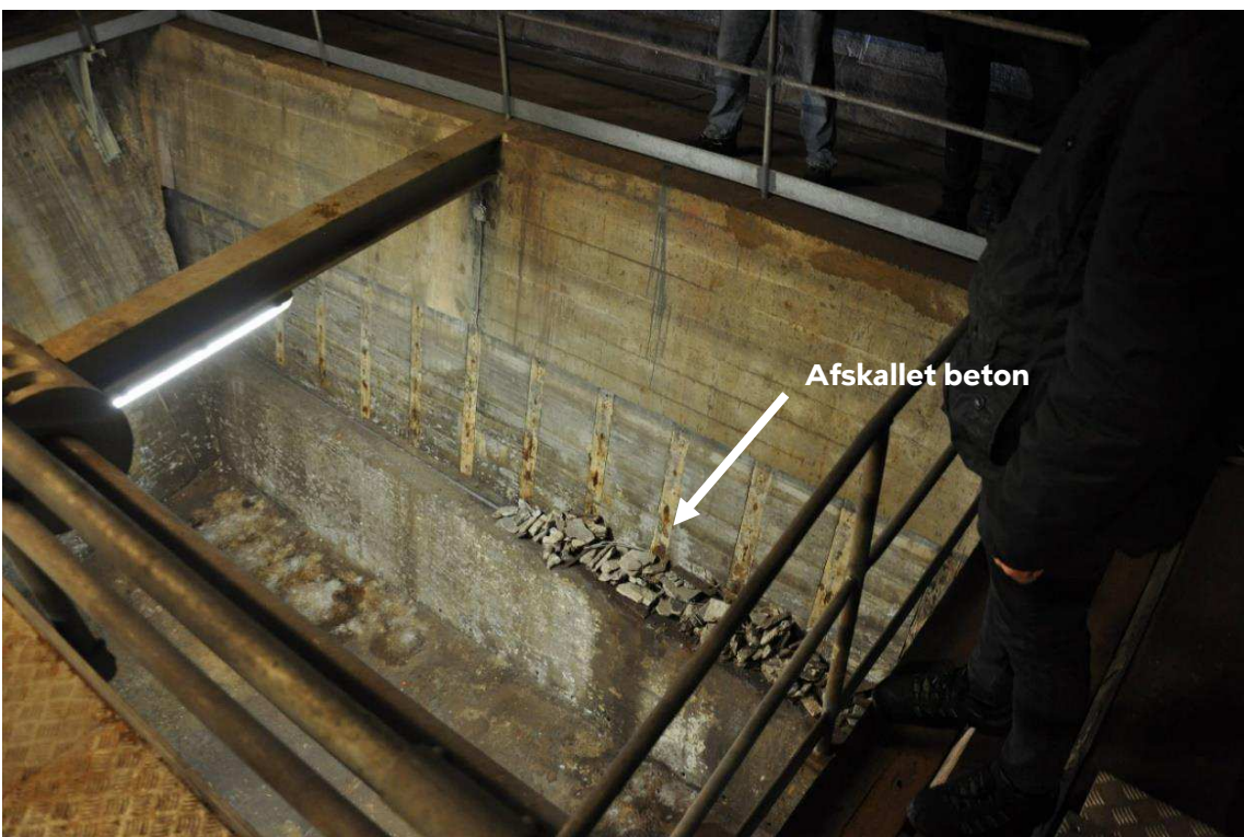
Afskallet beton fra kontravægten
