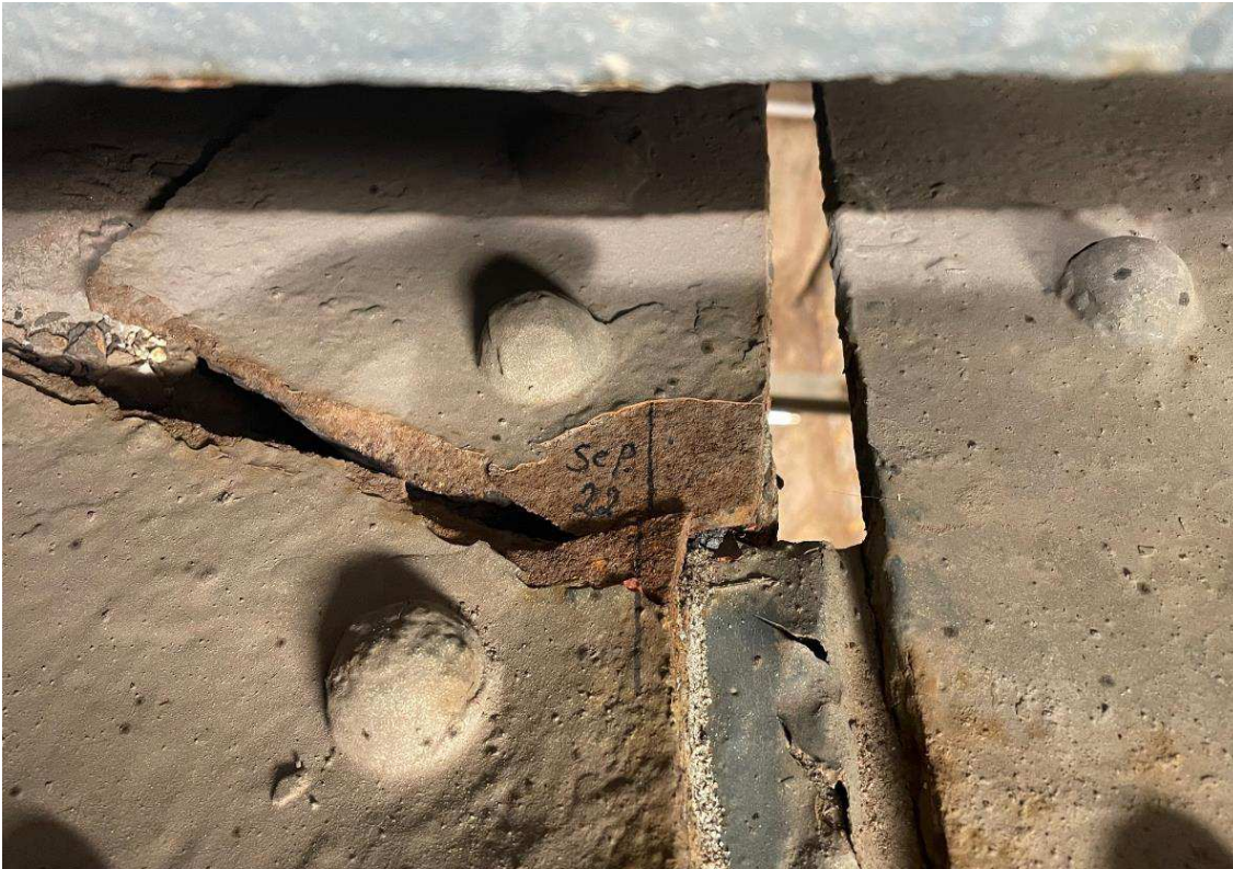
Stålbeslag på hjørnet af den faste kontravægt revnet/revet over pga. volumenudvidelse af ballastbetonen med indstøbt stålskrot. Skaden udvikles fortsat.
