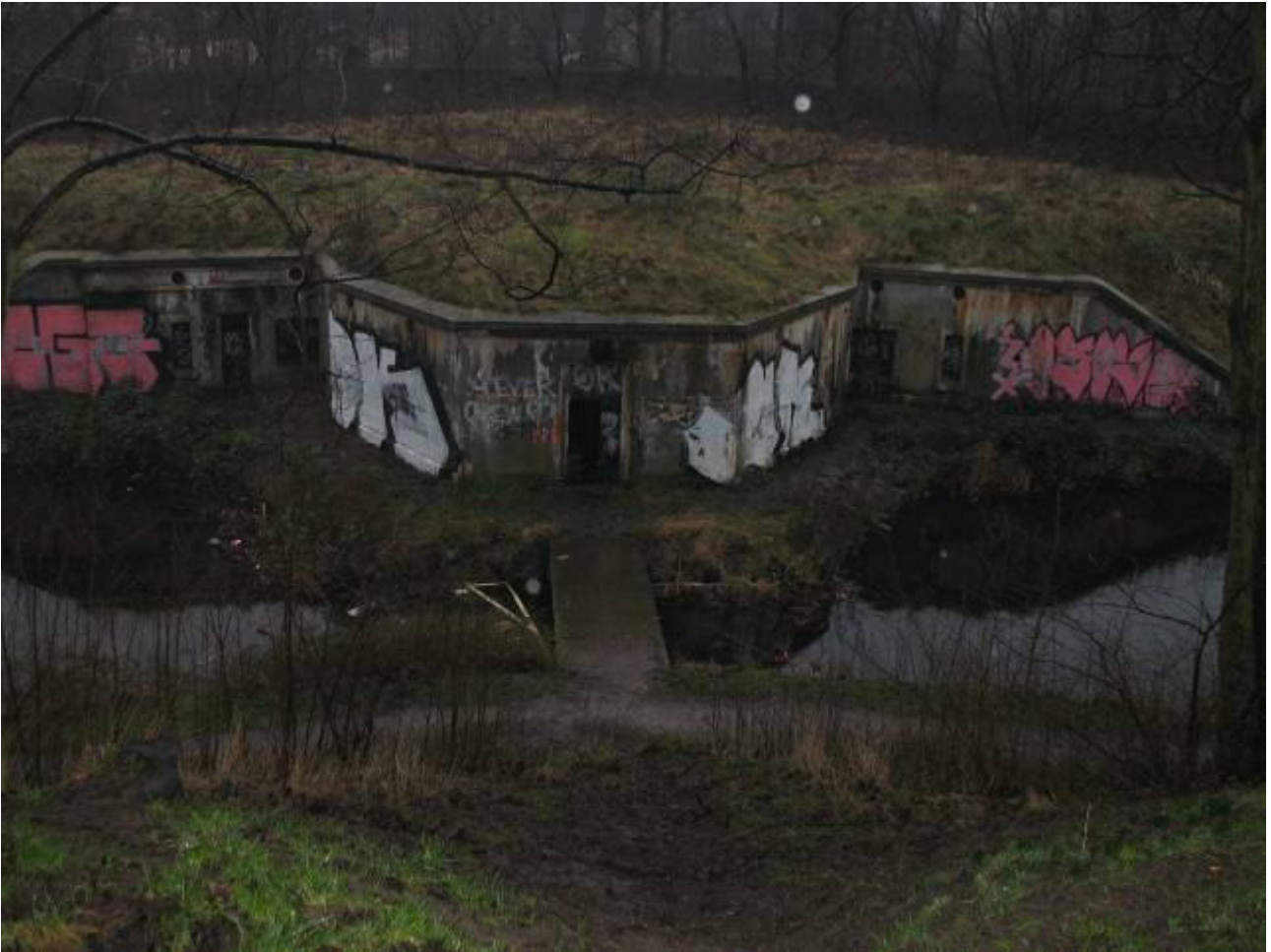
Kaponieren ved Frederikssundsvej. Et militærhistorisk bygningsværk, som lige nu ligger hen uden funktion, er plaget af graffiti og hærværk, samt i risiko for at gro til.
