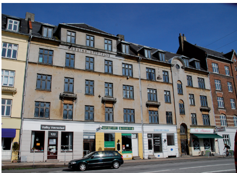
Ejendommen Valby Langgade 120 er et godt eksempel på en bygning med lav udvendig tilstand, som kan søge tilskud til byfornyelse.
