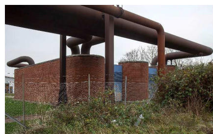
26. Teknisk anlæg ved Vasbygade.
