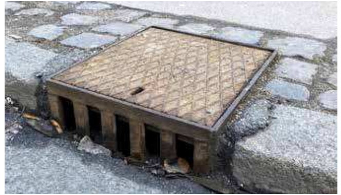
Sideindløbsbrønd på Gothersgade
