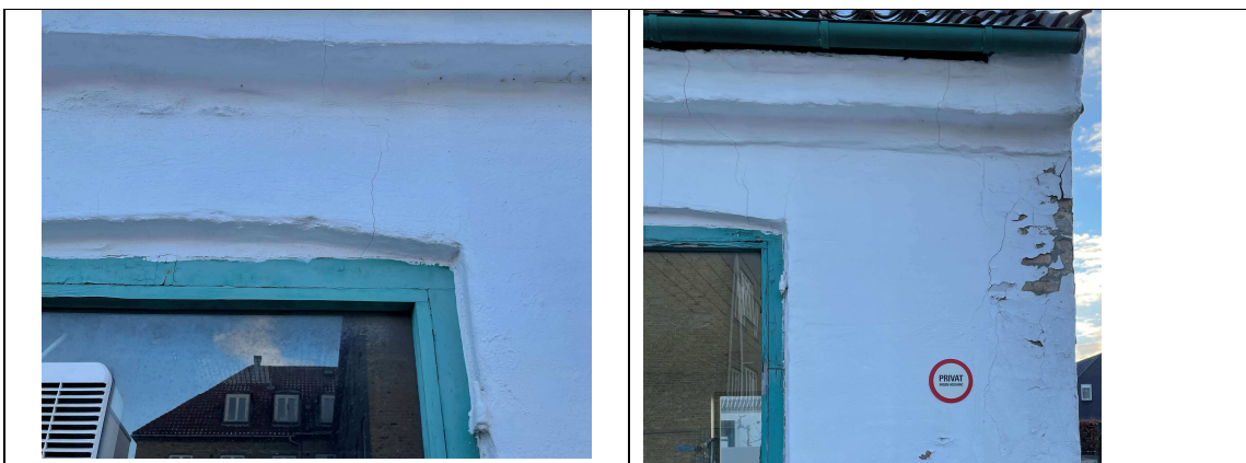
Billede 2 – Bygning 1 Revner omkring døre og vinduer
