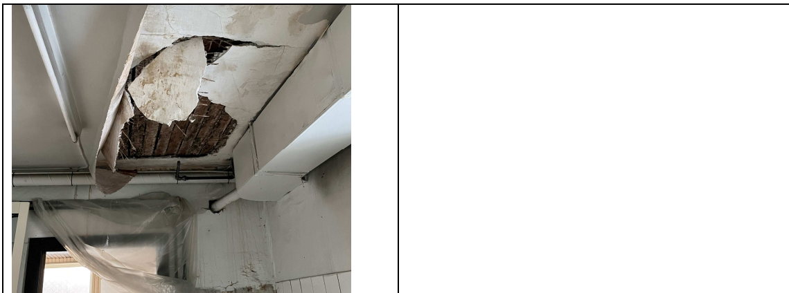
Billede 9 - Fugtskade indvendig grundet utæt tag
