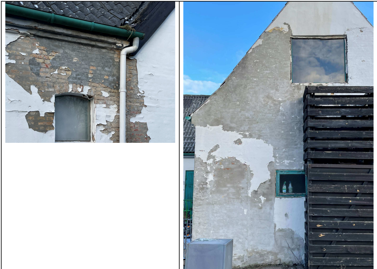
Billede 8 – Bygning 2 Fugtpåvirket murværk
