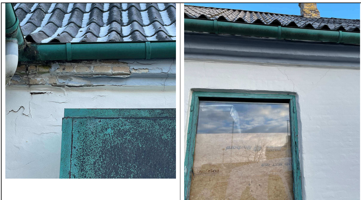
Billede 7 - Revner og opfugtet murværk
