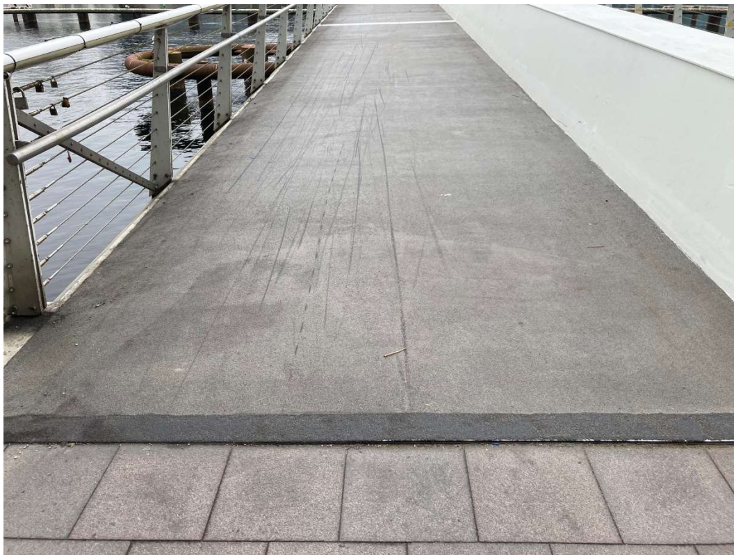
Figur 20: Foto af bremsespor på den nye belægning, der blev lagt på i sommerferien 2024.
