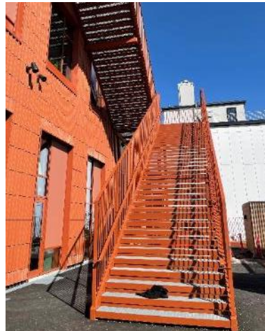
Billede af fordelingsstappe med stejl hældning som ikke vurderes at kunne anvendes til leg og ophold på Nordøstamager Skole
